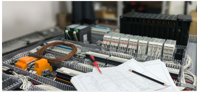
Разработка шкафов автоматизации процессов – новое направление в работе Инженерно-инновационного центра
